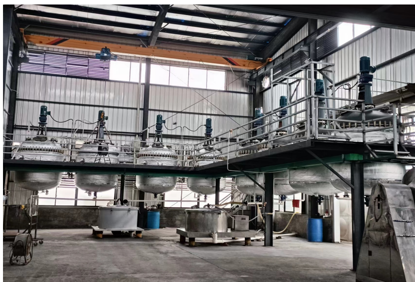
图二 现场设备布局照片
